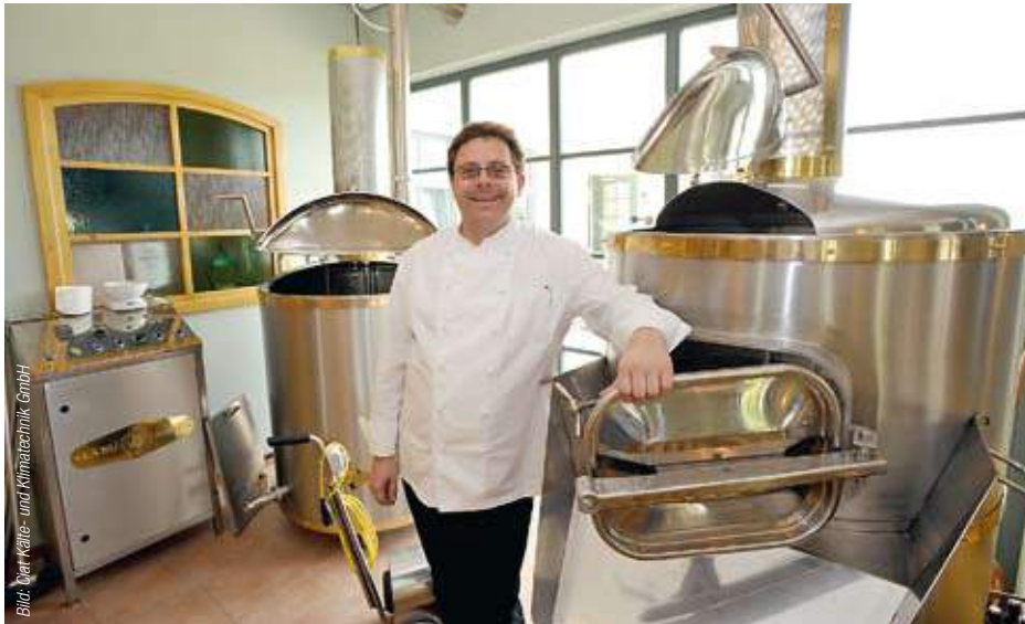
Hobbybrauer Andreas Ufertinger hat seine Bierbrauerei in einen der Gasträume integriert. Zweimal pro Woche wird hier ein naturtrübes helles Bier gebraut. Die erforderliche Kälteanlage ist in das Energiekonzept integriert, die Rückkühlung erfolgt im 5000-l-Schichtenspeicher des Heiz-Systems.
