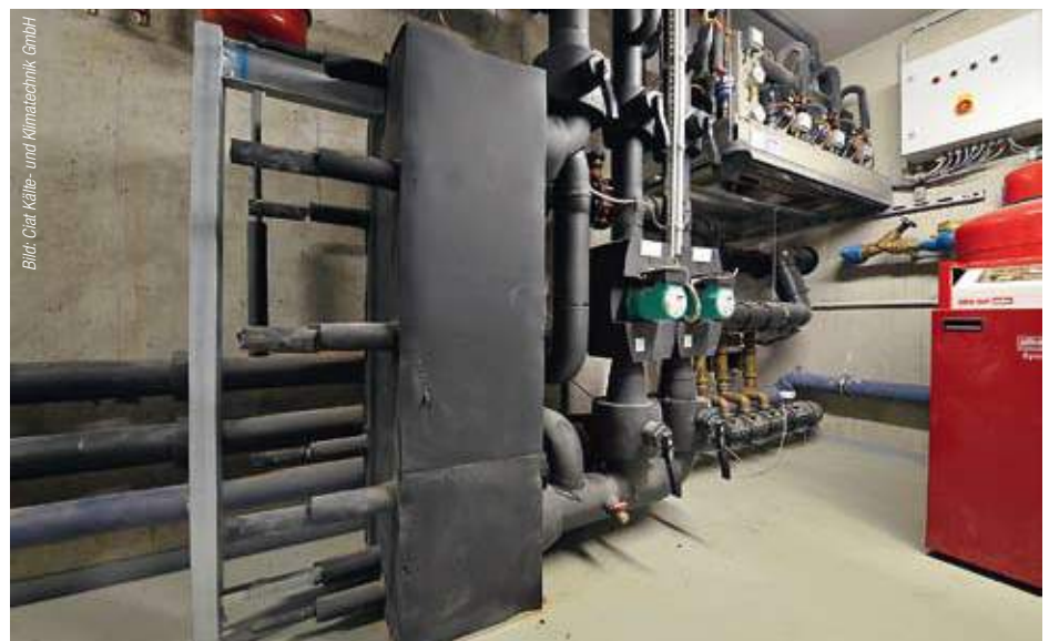
Ein geschraubter Plattenwärmeübertrager trennt den Grundwasserkreislauf von dem internen Kühl-/Kaltwasserkreislauf, weil dieser sowohl als Wärmequelle für die Wärmepumpe als auch zur direkten Kühlung der Gastronomie und Tagungsräume genutzt wird.
